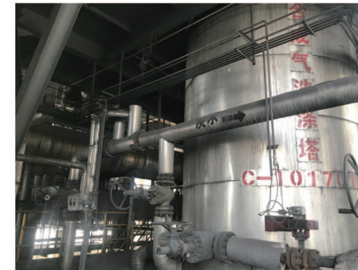
阳煤集团太原化工新材料有限公司 己内酰胺、乙二醇项目 Technical Reform Project for Gasification of YANGMEI GROUP TAIYUAN NEW CHEMICAL MATERIALS CO.,LTD
